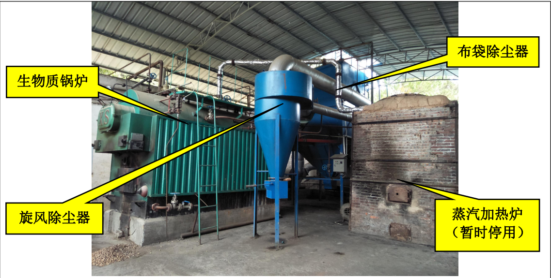
锅炉技改废气处理设施全貌
